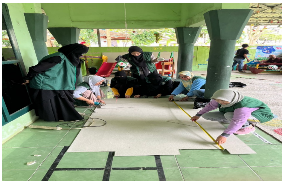
Gambar 1. Kegiatan Memperbaiki Plafon Bocor
